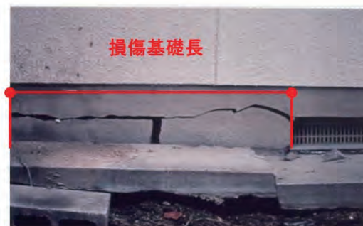
出典 被災建築物応急危険度判定マニュアル
