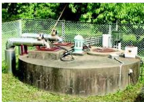
写真 4-30 取水井・取送水ポンプ
