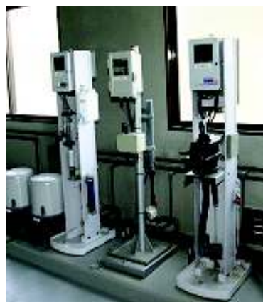
写真 4-47 残塩・濁度計
