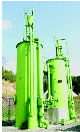
写真 4-45 急速ろ過装置
