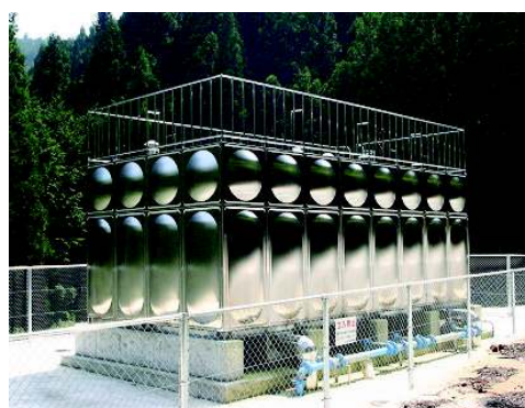
写真 4-77 新城配水池(容量:82m 3 )
