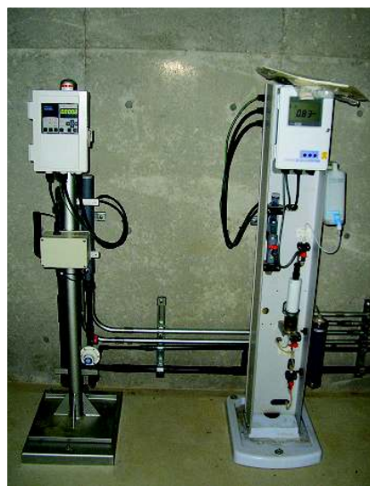
写真 4-59 残塩・濁度計
