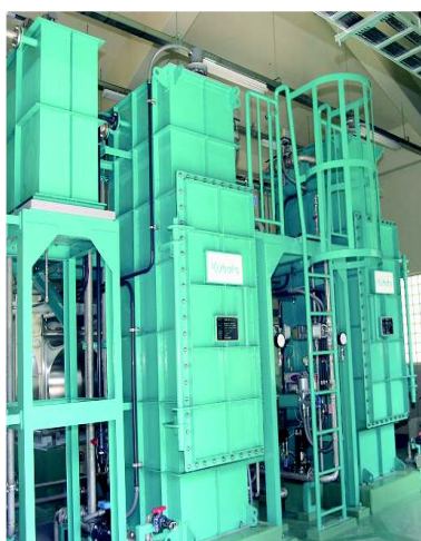
写真 4-50 膜ろ過ユニット
