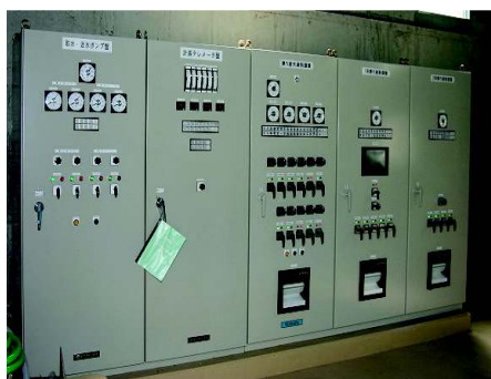
写真 4-41 テレメーター
