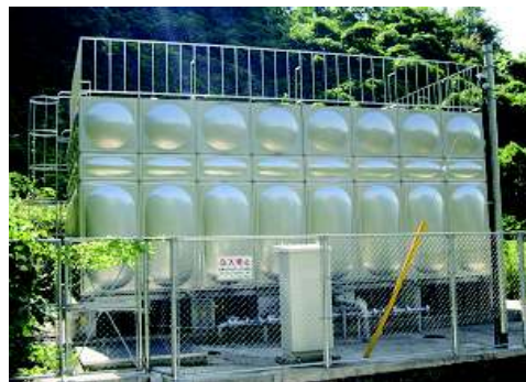
写真 4-73 柏木配水池(容量:226m 3 )
