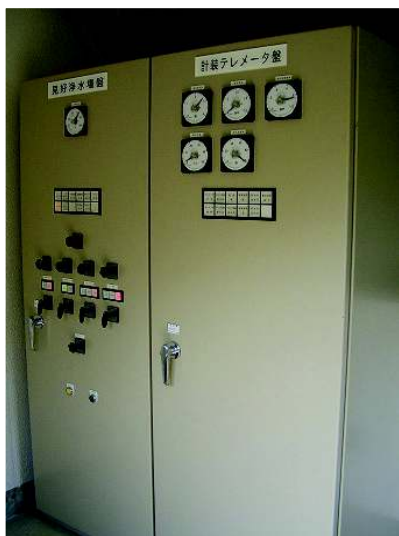
写真 4-58 テレメーター
