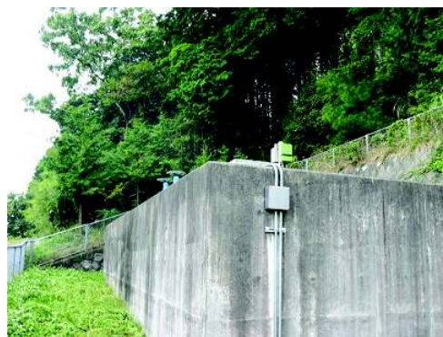
写真 4-75 大久保配水池(容量:109m 3 )
