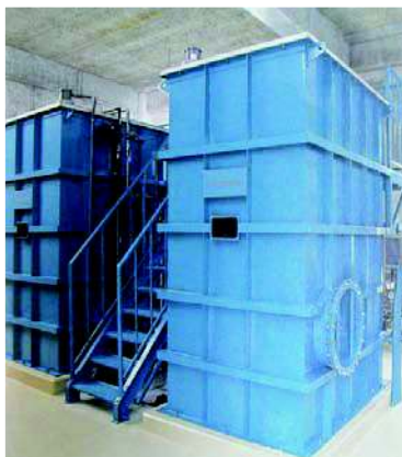
写真 4-39 膜ろ過ユニット
