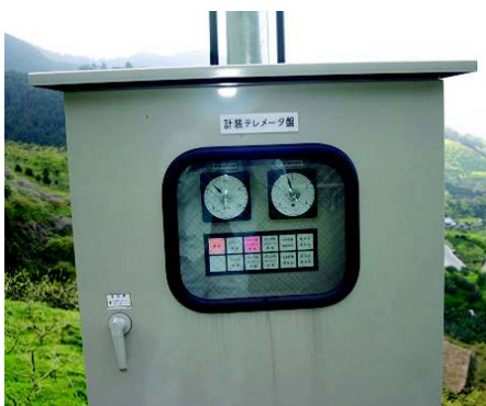
写真 4-64 テレメーター
