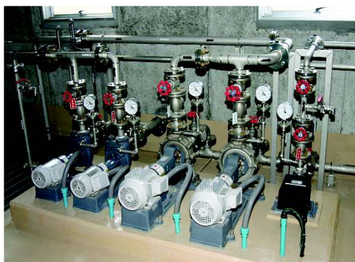
写真 4-38 原水・洗浄ポンプ
