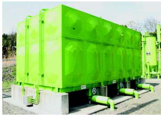
写真 4-43 着水井・一次/二次浄水池
