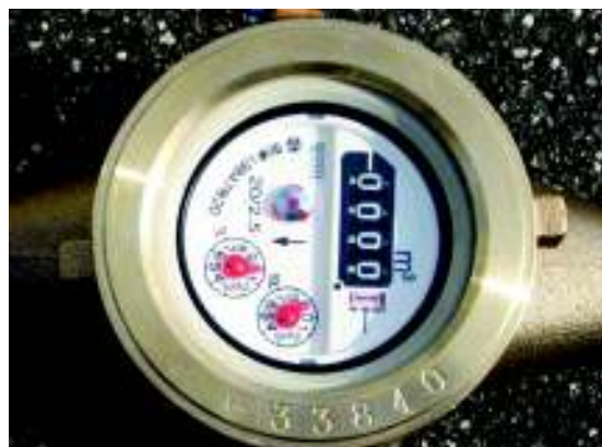
写真 4-84 水道メータ（指針部）
