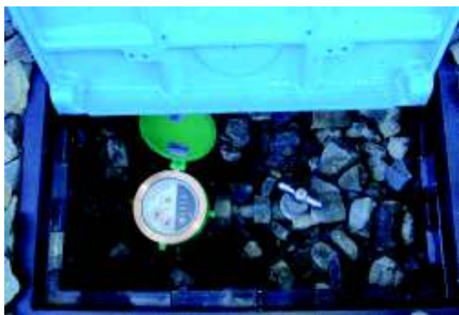
写真 4-83 一般家庭用水道メータ設置状況
