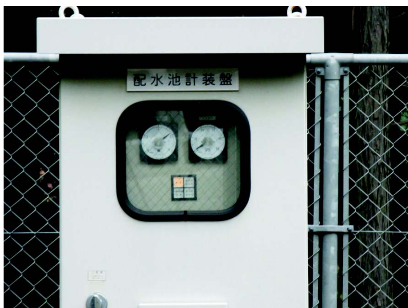
写真 6-5 配水池 計装盤
