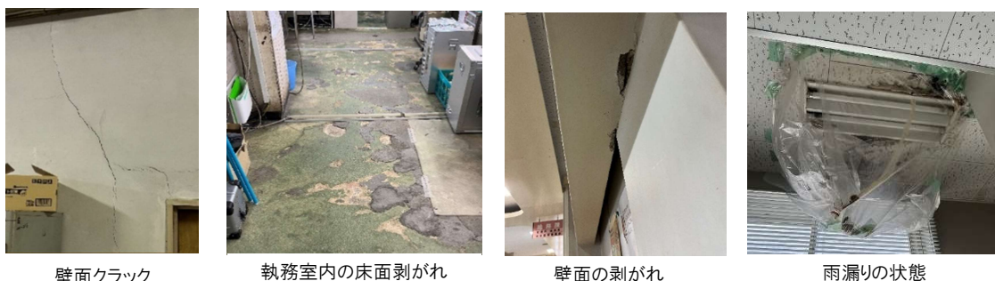
壁面クラック
