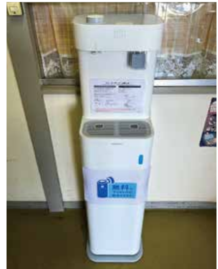
三谷公民館に設置したウォータースポット
