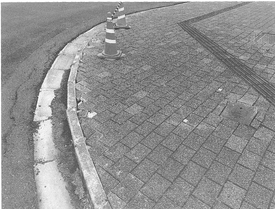
かつらぎ公園内の破損状況（プール周辺）
