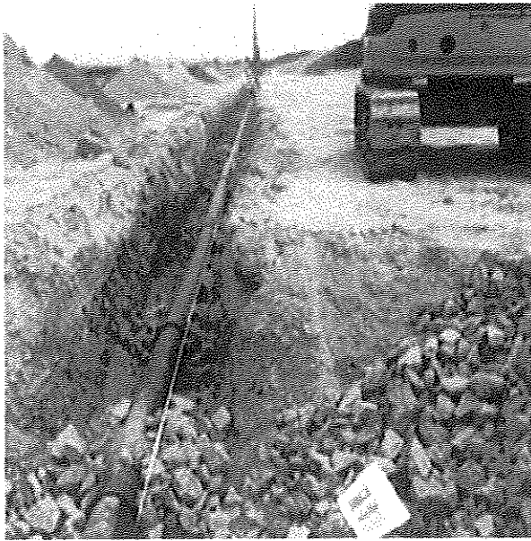
ガス誘導管（横引き管）
