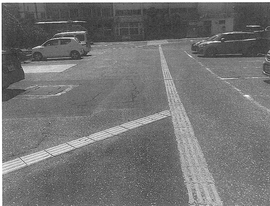
利用されていない点字ブロック
