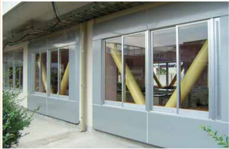
笠田中学校の耐震ブレース(筋交い) 〈平成21年9月撮影〉
