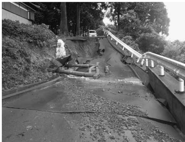
台風12号により町道が崩壊（宮本町内）
