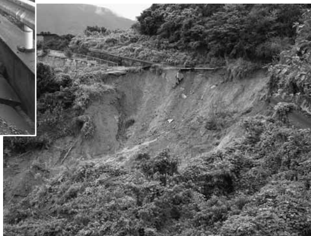
農道が崩落（平沼田町内）
