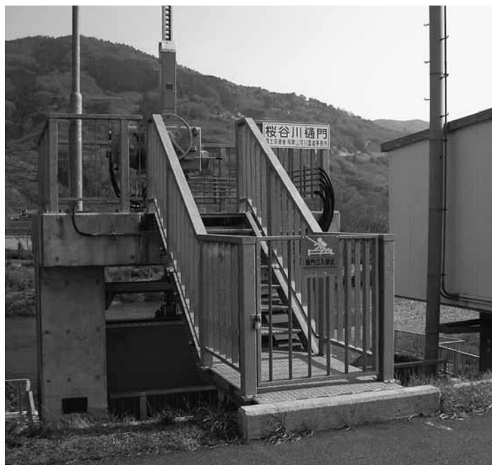
2人では足りない樋門操作
