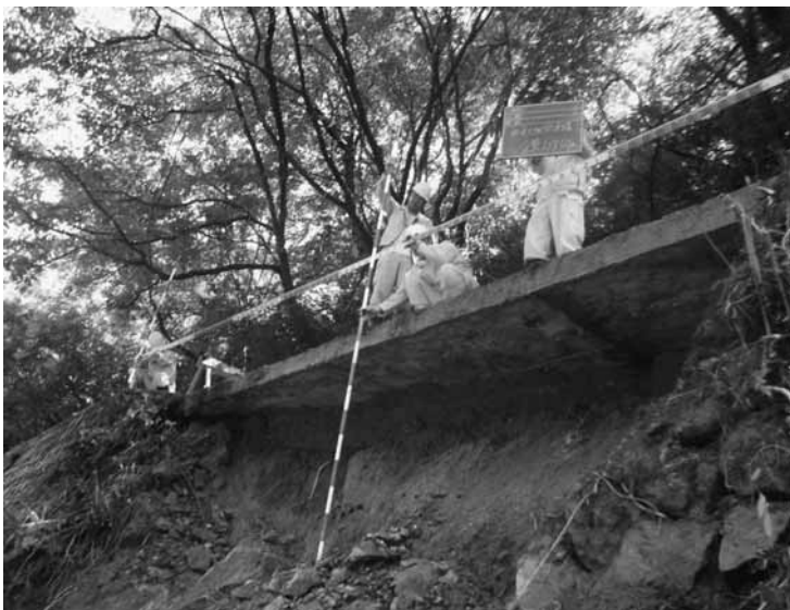
災害現場（大畑地内）
