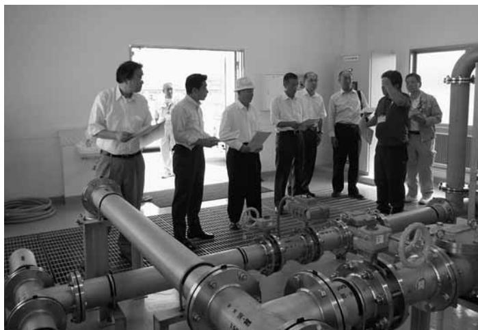
妙寺浄水場紫外線処理施設
