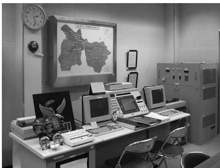
九度山町 防災行政無線司令室
