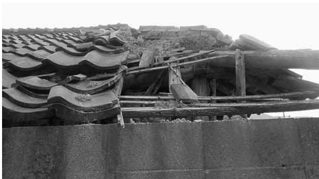
空き家(瓦が落ち、屋根の一部がくずれている)
