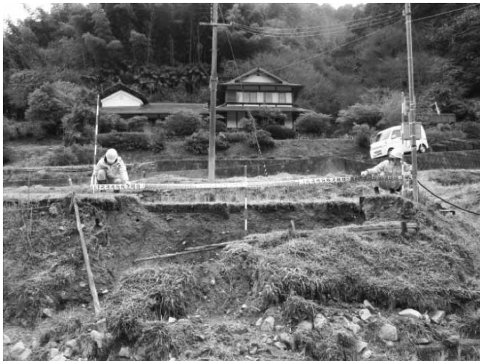
台風によって崩れた農地
