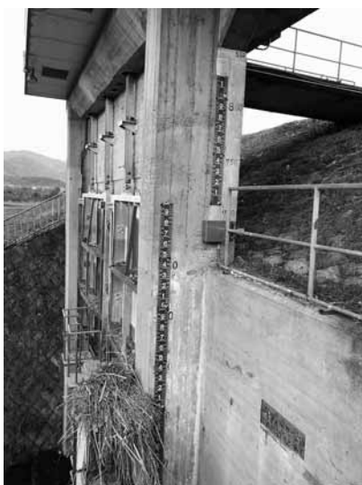
西渋田谷川樋門に設置したポンプが可動しなかったことを町が把握できたのは翌日だった
