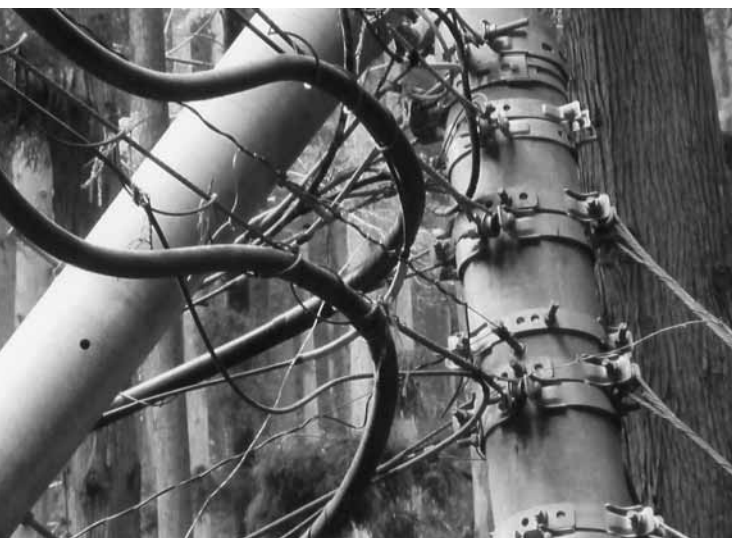
台風21号で電柱が倒れ、道路がまだ通行止め (平成30年10月2日現在)
