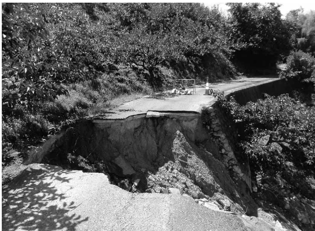
町道丁ノ町2号線の崩落現場
