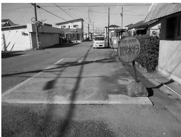
消防施設の中で初動活動に適している防火水槽
