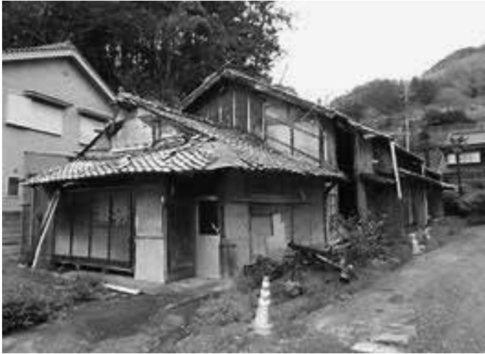
老朽化した空き家（例）
